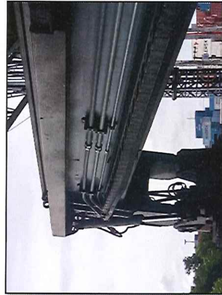
Local: Lança Item # 45: calha da esteira cabltrack da lança está amassada. Status: corrigido .
