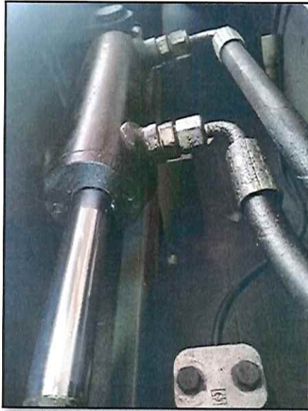
Local: Spreader Item # 22: vazamento de óleo hidráulico em ambos cilindros de acionamento dos twist-locks . Status: corrigido .
